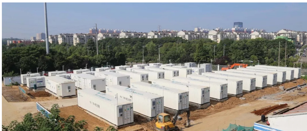
Рис. 2. Система накопления электрической энергии (СНЭЭ) мощностью 100 МВт компании Zhongtian Yipin Technology
