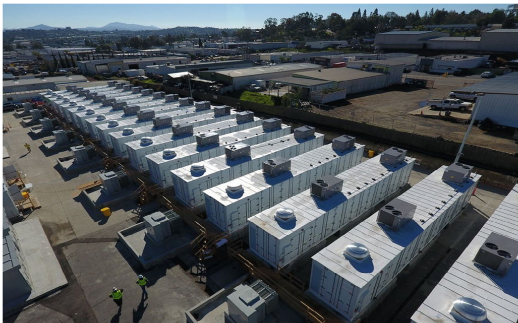
Рис. 3. Система накопления электрической энергии (СНЭЭ) в Сан-Диего 30 МВт, емкость 120 МВт·ч
